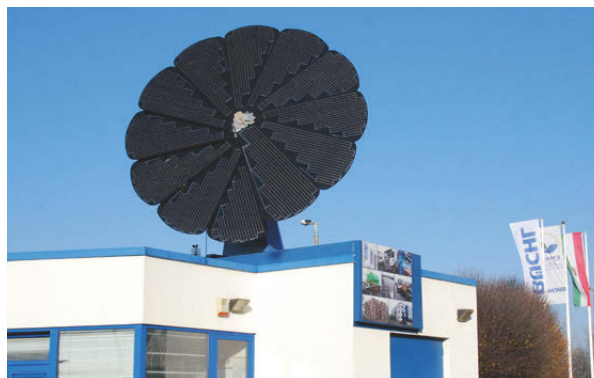
Die Energieproduktion in der BÜCHL Hungaria KFT erfolgt durch Photovoltaik-Anlagen auf den Werkhallen. Die PV-Anlage im Eingangsbereich ist ein „Eyecatcher“ für Kunden und Gäste.
